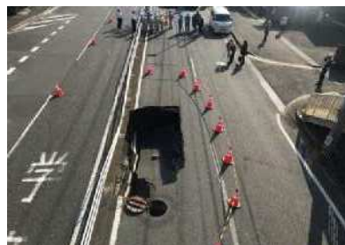
下水道管渠破損による道路陥没
