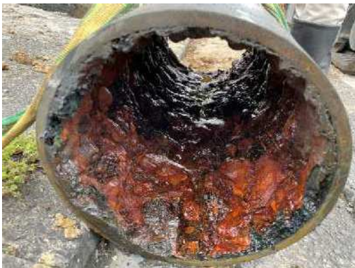
S38年以前に整備した水道管（配水管）
