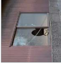
窓が割れた管理不全空家
