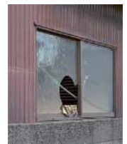
窓が割れた 管理不全空家
