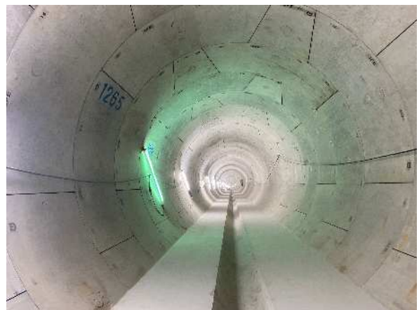
雨水貯留管(昭和町貯留管施工例)
