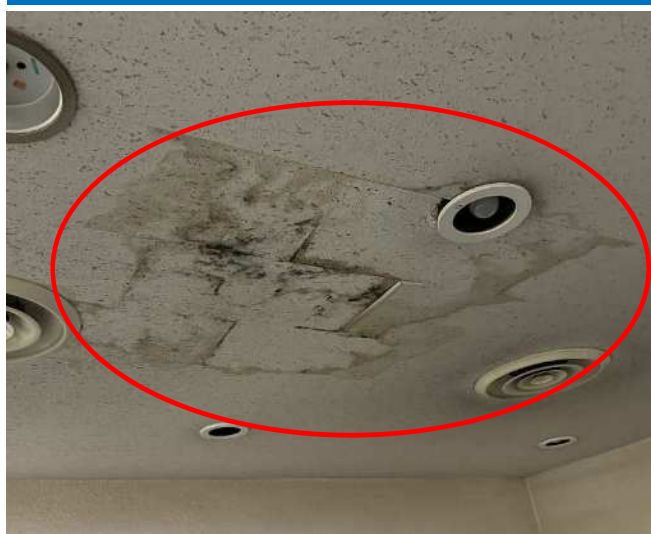
天井の雨漏り
