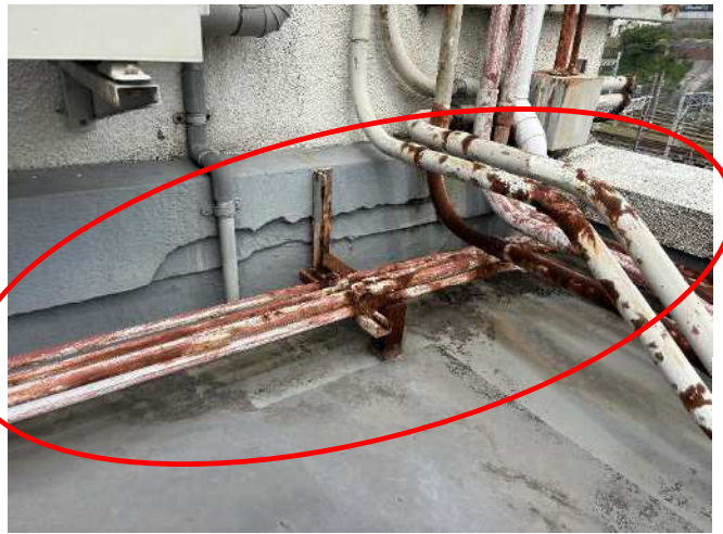
設備配管の腐食
