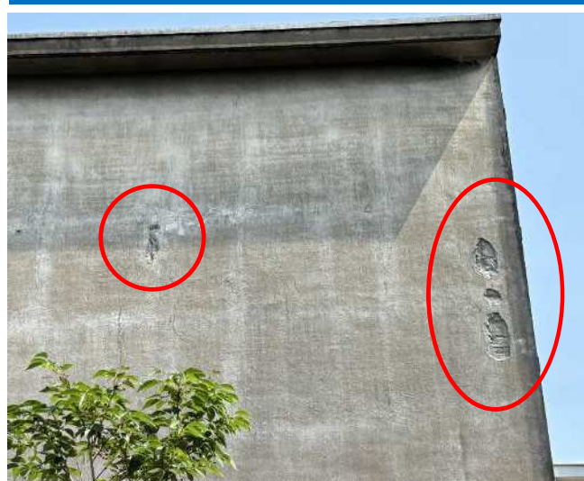
外壁の剥落、鉄筋の露出
