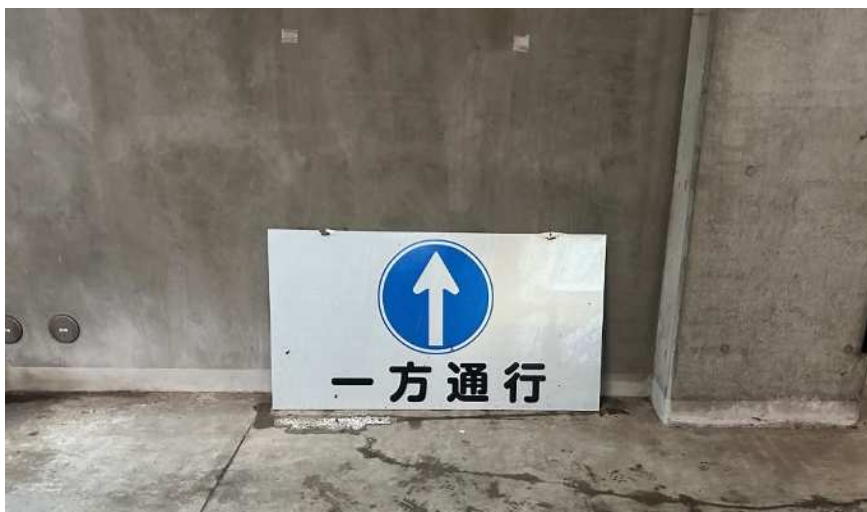
<①落下した表示板>
