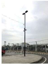
防犯カメラの設置
