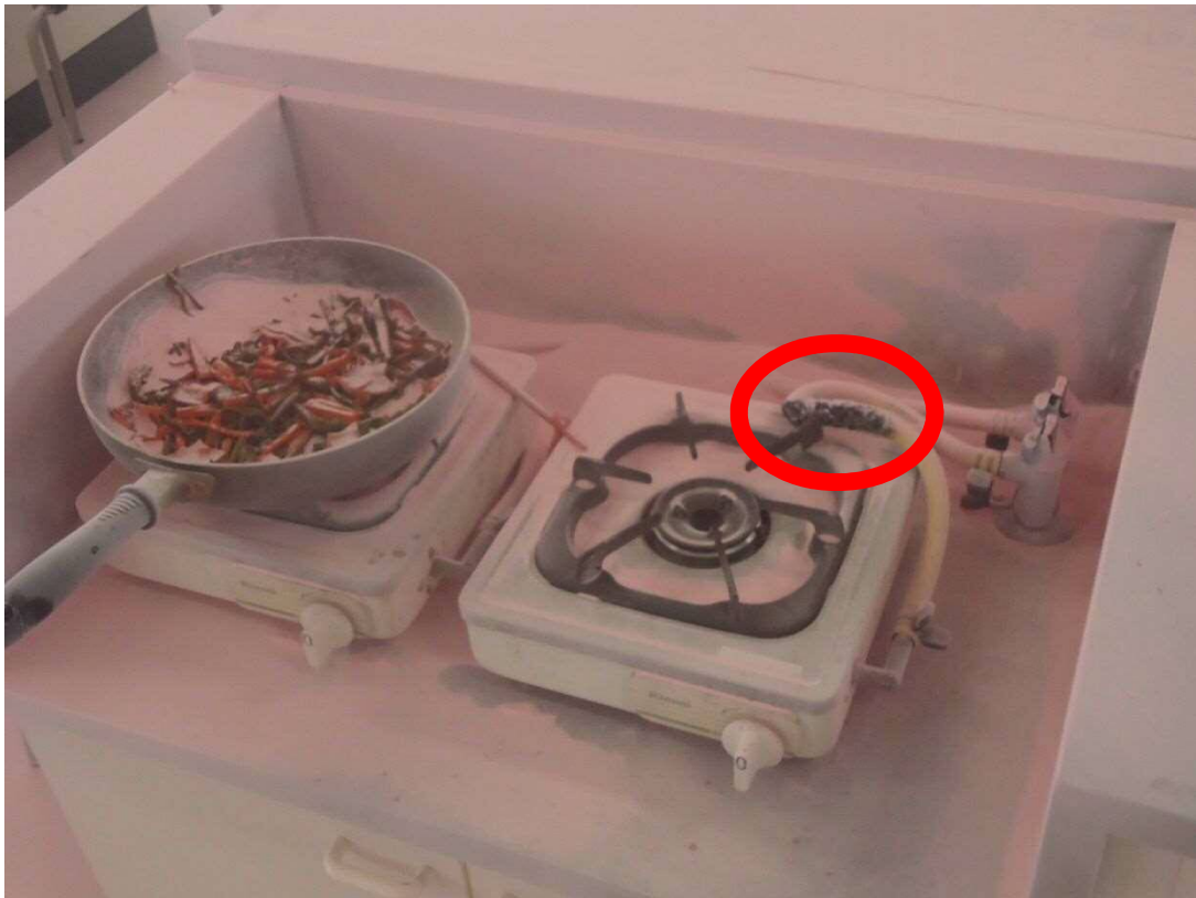
【消火直後のコンロ】
