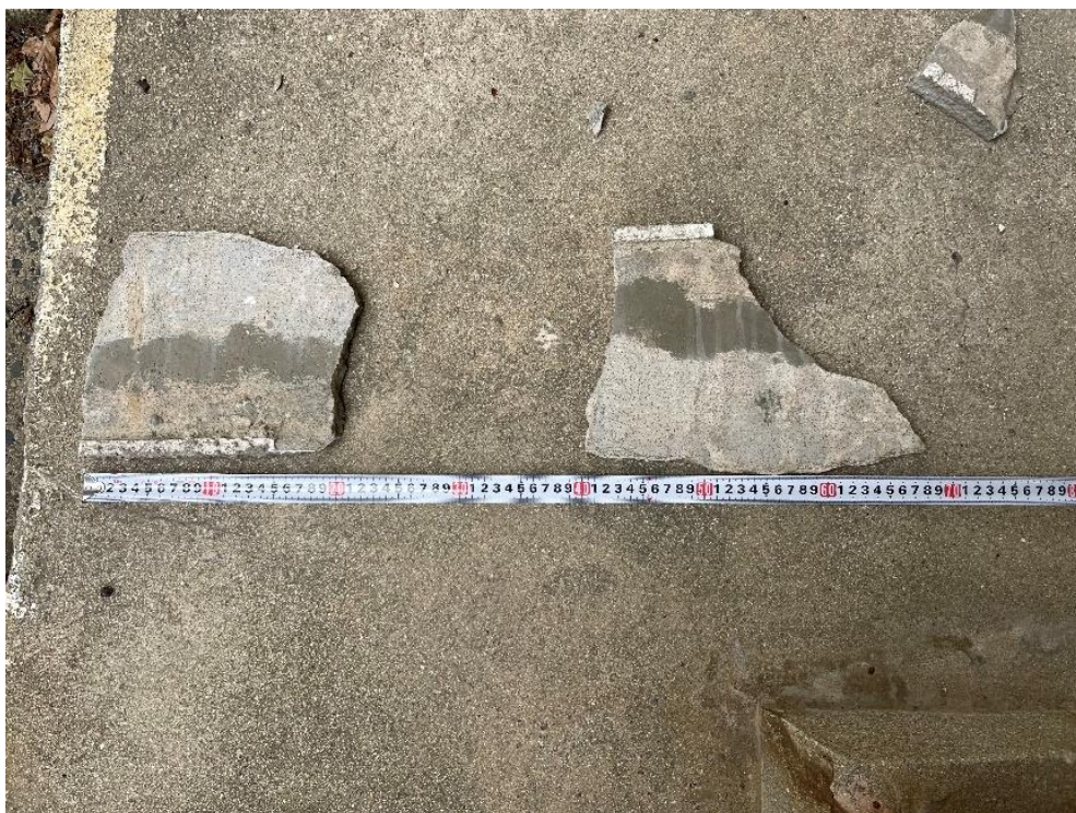
【落下した外壁の破片】
