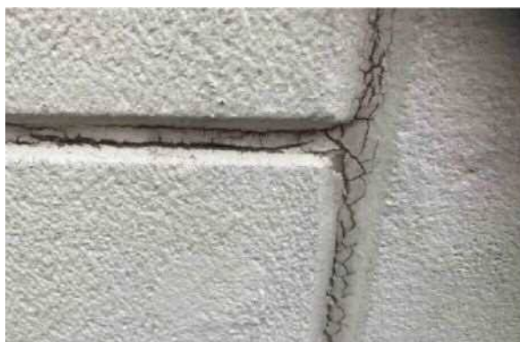
シーリング材の劣化（割れ）
