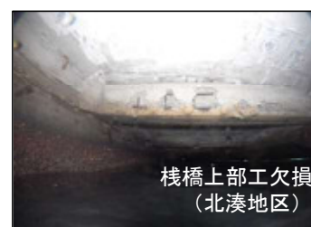
図 2-20 老朽化の状況
