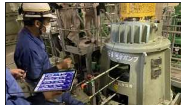
汚水ポンプの点検
