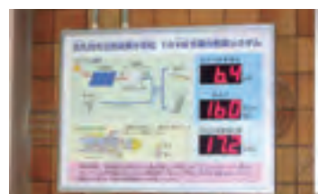
電力モニター
