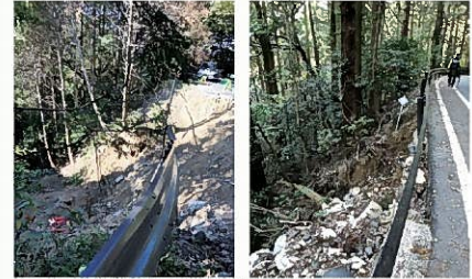
人工林(杉)は放置人工林で根が張らず表土が流れ大雨で土砂崩れた様子です。
