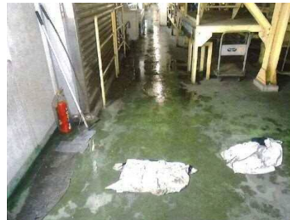
選別室内の雨漏り
