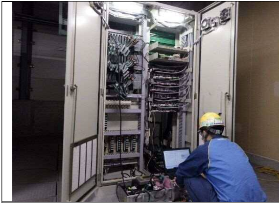
9. 中央制御室 システム点検
