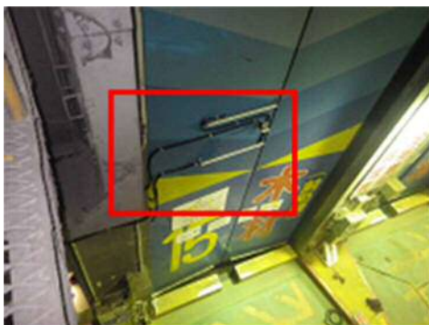
カメラ等の設置状況
