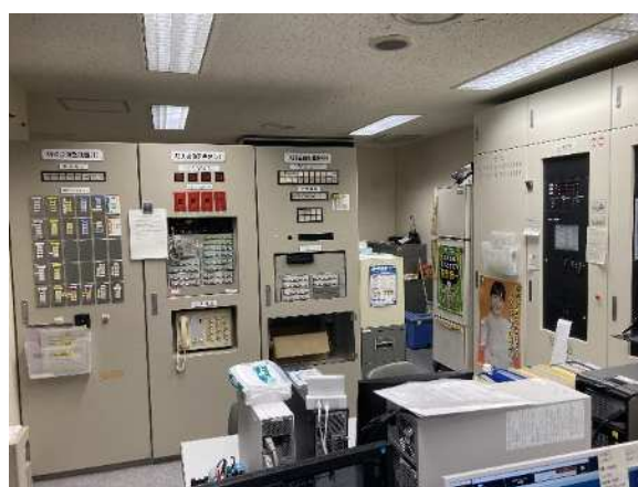
(防災盤 本庁舎地下1階)
