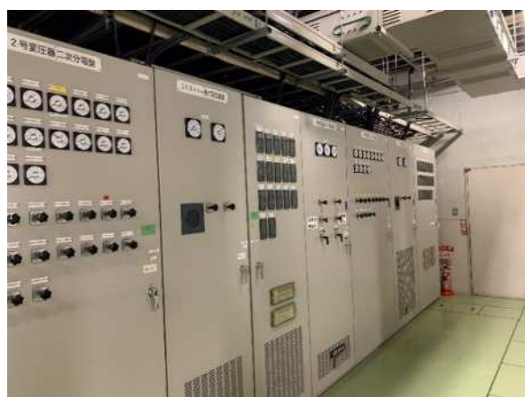
(受電設備 本庁舎地下3階)
