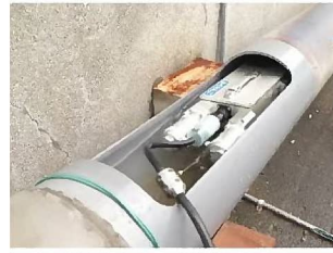
上下水管、プラント配管
