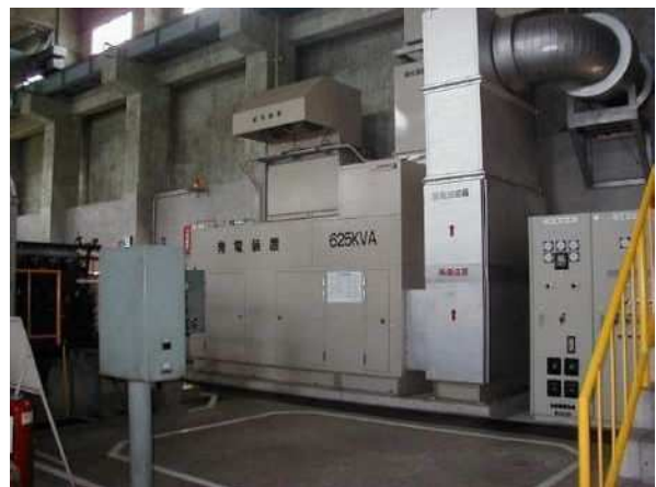
非常用発電設備（浅野町ポンプ場）
