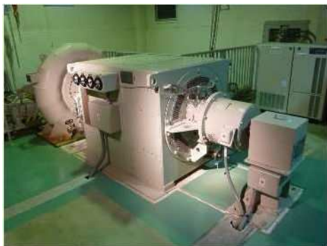
ます湊発電所(520kW)
