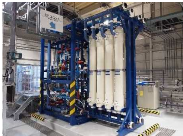
海水淡水化システム
