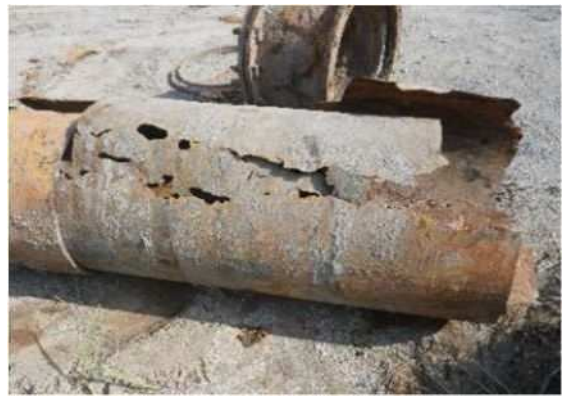
硫化水素により腐食した圧送管
