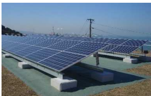
太陽光発電(二島配水池)
