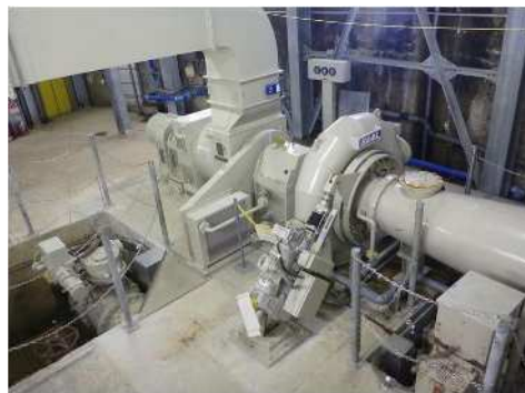
油木発電所(780kW)
