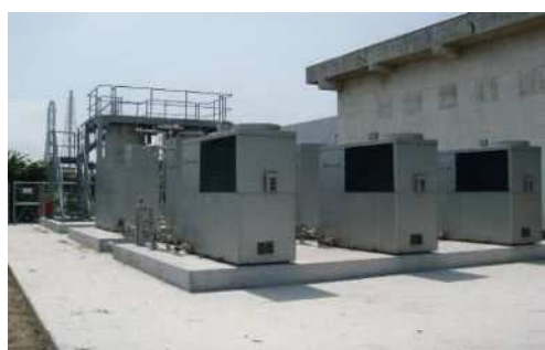
バイオガス発電*(日明浄化センター)
