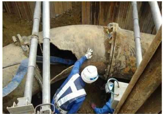
破損した水道管
