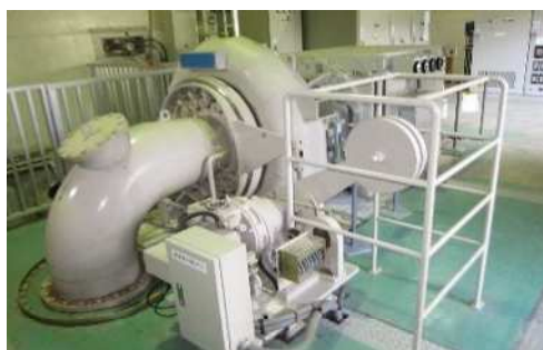
水力発電(ます淵発電所)
