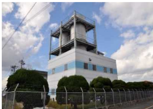
活性炭注入設備
