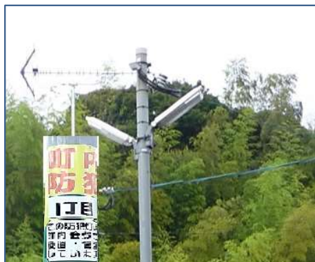
(LED化した防犯灯)
