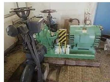
ポンプ設備更新前
