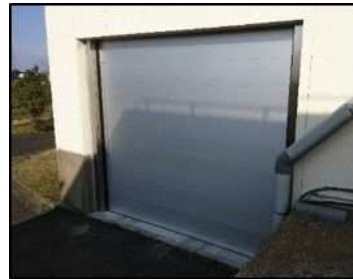
防水扉（防水シャッター）の整備状況
