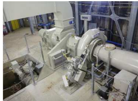
油木発電所(780kW)
