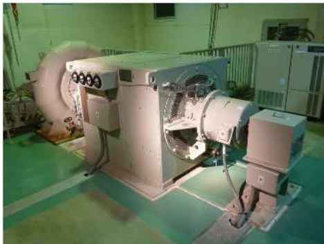
ます湊発電所(520kW)
