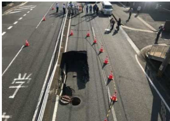
下水道管渠破損による道路陥没
