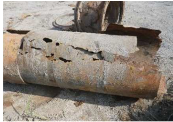
硫化水素により腐食した圧送管
