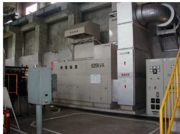
非常用発電設備(浅野町ポンプ場)
