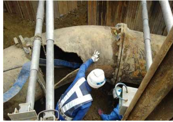
破損した水道管
