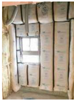
浴室外壁に断熱材を設置した例
