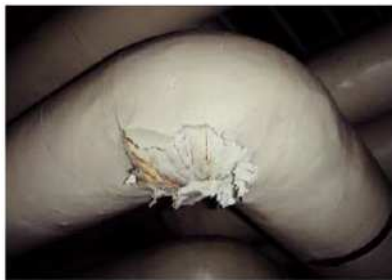
配管エルボの保温材
