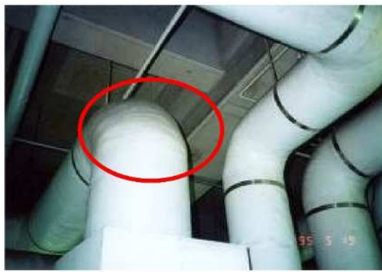
保温材（配管等）
