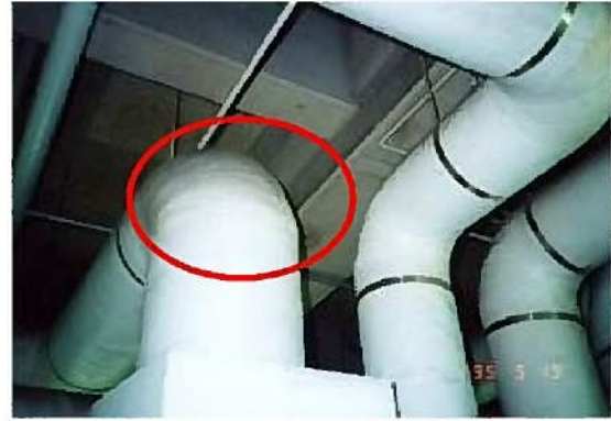
保温材（配管等）
