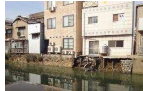
市場対岸側の護岸の崩落 (H26年3月)
