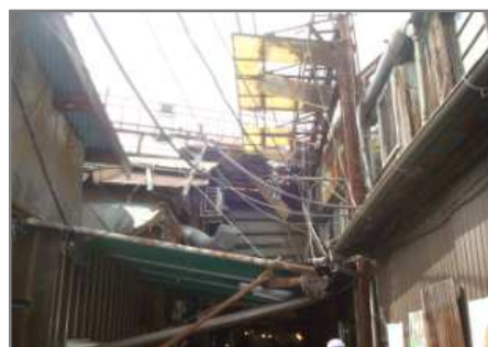
木造建物等の老朽化
