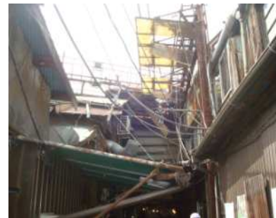
木造建物等の老朽化
