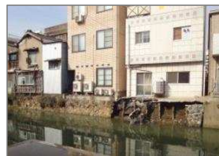
護岸の崩落（H26年）
