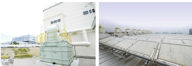
・活性炭による脱臭装置。(写真左) ・汚泥受入棟上には光触媒による脱臭装置を設置しています。(写真右)
