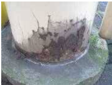
とみのっ子横断歩道橋(橋脚腐食)
