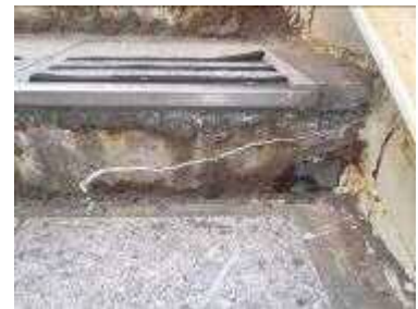
日吉横断歩道橋(階段部腐食)
