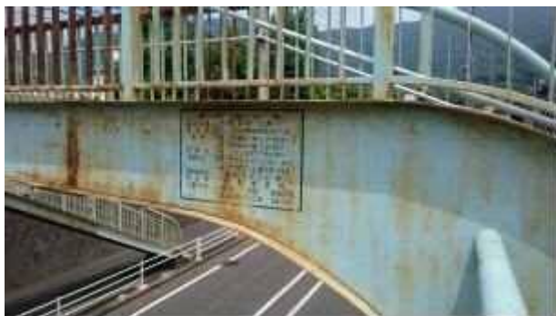
写真 3.2 修繕前の状況
