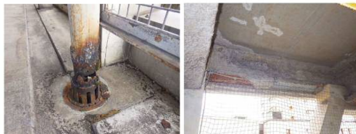
柱下部の腐食・破損
