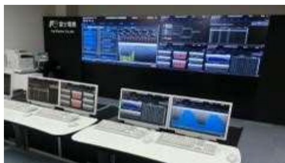
写真 地域節電所
