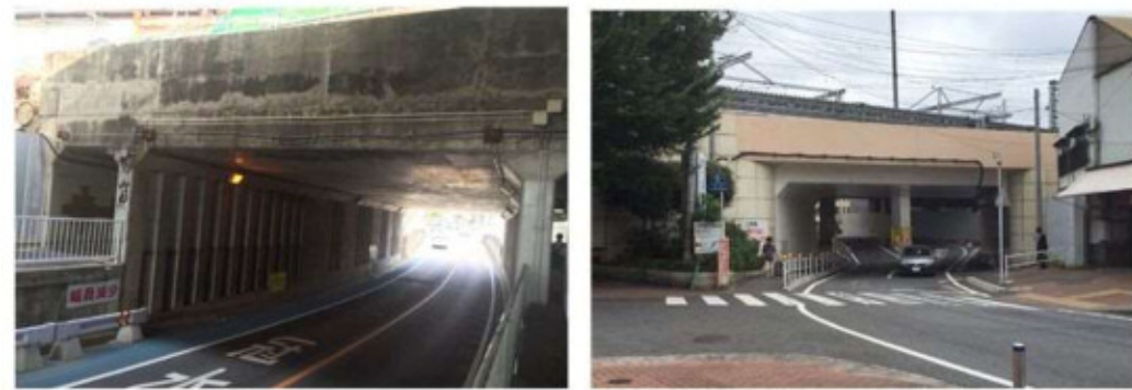
現況：既設構造物(左写真：折尾中間線ボックス、右写真：折尾停車場線ボックス)
