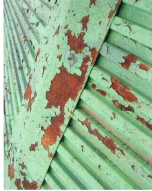
金属屋根の腐食
