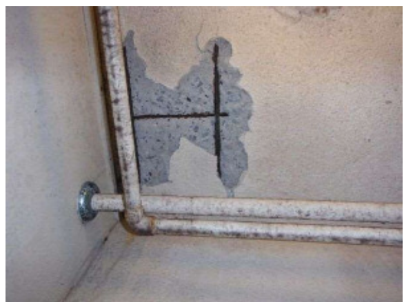
写真1 コンクリートが落下した後の天井
