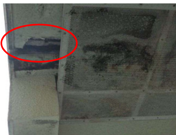
写真3 継ぎ目の劣化
