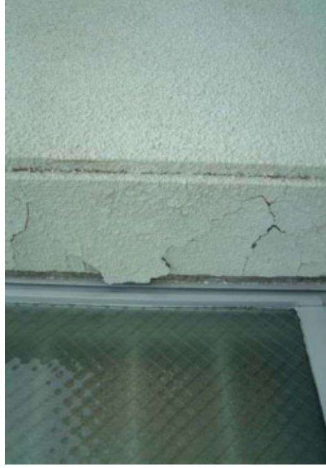
塗装仕上げ材の浮き・はく落
