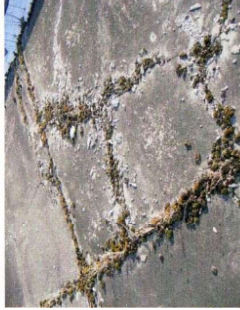
防水保護コンクリートの亀裂
