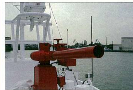
電動放水砲 (1基)
