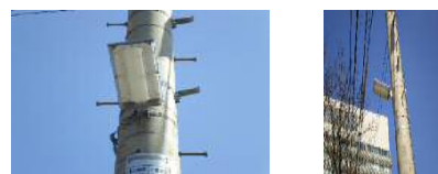
▲道路照明（LED灯）
