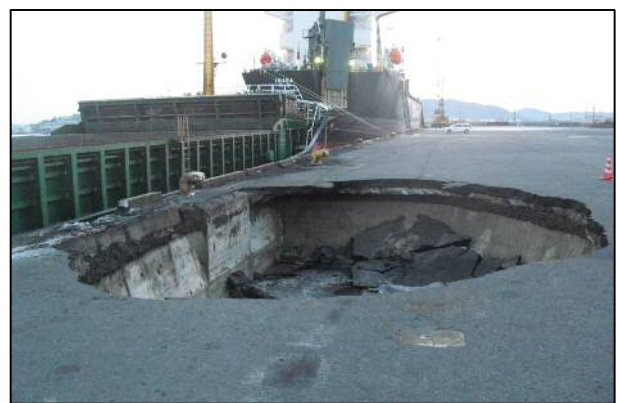
陥没したエプロン
