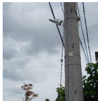
LED化された防犯灯
