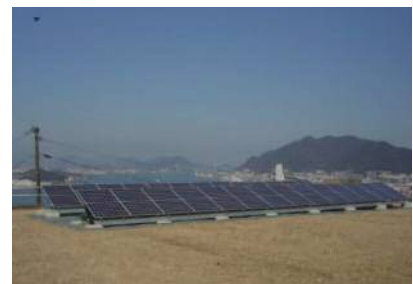
笹尾配水池太陽光発電（門司区）
