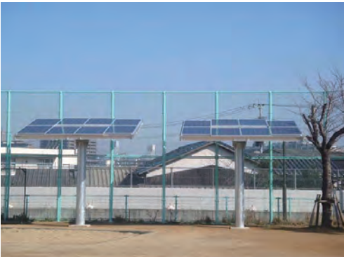
太陽光発電設備（出力3KWの設置例）
