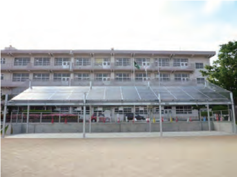
太陽光発電設備（出力10KWの設置例）
