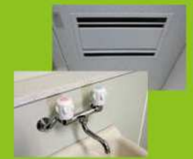
施設内の給湯・冷暖房に活用
