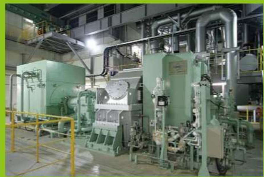
蒸気タービン発電機
