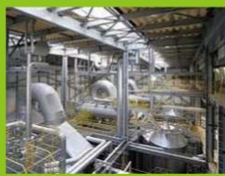
燃焼室～ボイラ～排ガス温度調節器
