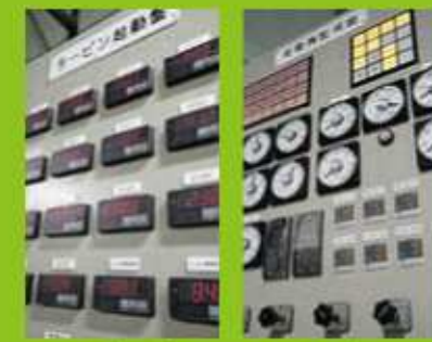
タービン起動盤 発電監視盤
