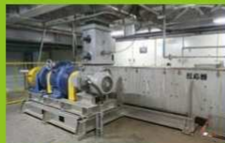
飛灰処理装置
